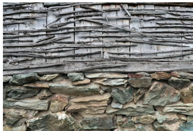
Kuća sa konstrukcijom sprata „na dizmu“ i detalj konstrukcije, zona između Berana i Crnog vrha
